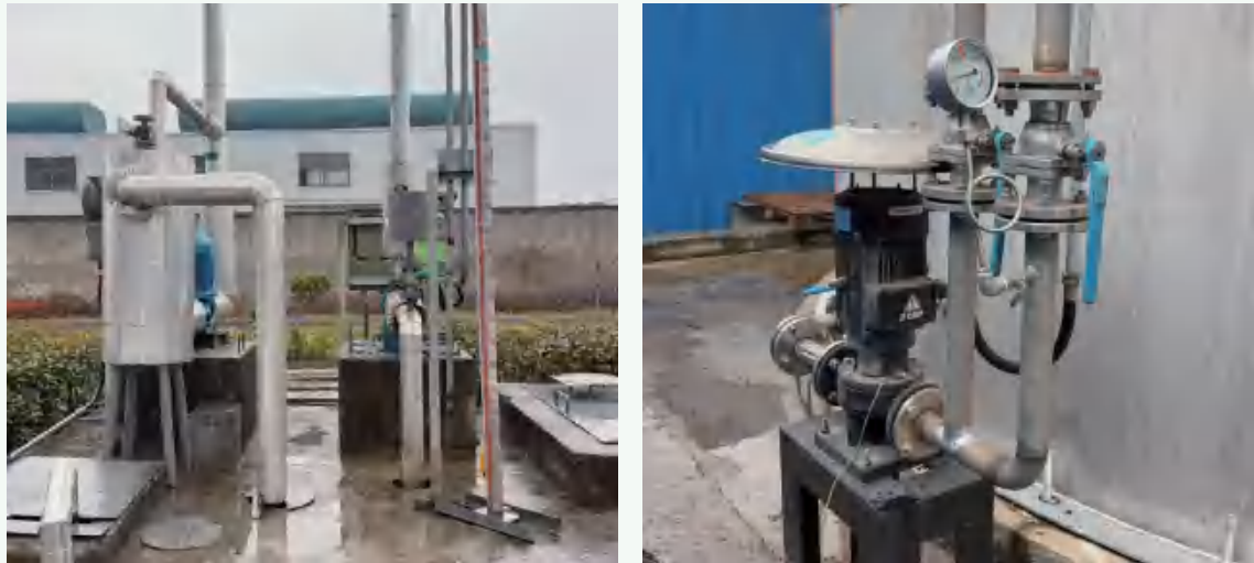
马鞍山科思设置罐区集水池和回用泵
